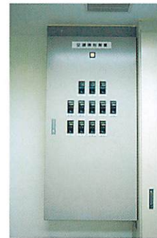
図1.22 温湿度制御盤
