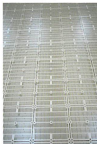
図1.13 グレーティング床(更衣室)
