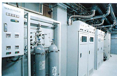
超高純度ガス設備室
