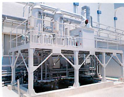
排気、廃液処理設備
