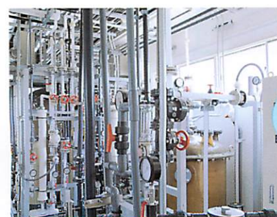
超純水製造室 (クリーンエリア外) 世界最高性能の超純水を製造し、各室に供給します。
