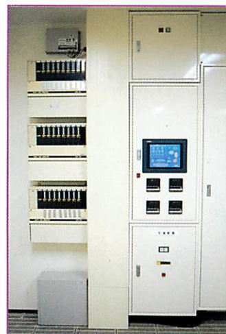
安全管理用集中制御盤
