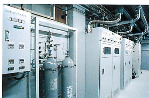
超高純度ガス設備室
