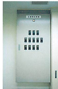
図1.22 温湿度制御盤
