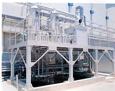
排気、廃液処理設備
