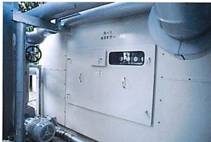
図1.21 水冷式チリングユニット
