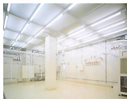
EEM室 (Class 1) 壁面・床面に耐水性材料を使用し、撥水性ULPAフィルターを採用した世界初の防水仕様の超高清浄度クリーンルームです。
