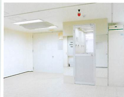
更衣室 (Class 1000) 安全管理用集中制御盤、クリーンルーム内モニターシステムを装備しています。
