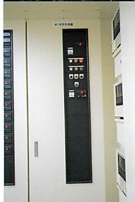
図1.10 外気処理機制御盤
