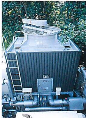
図1.20 冷却塔 (クーリングタワー)
