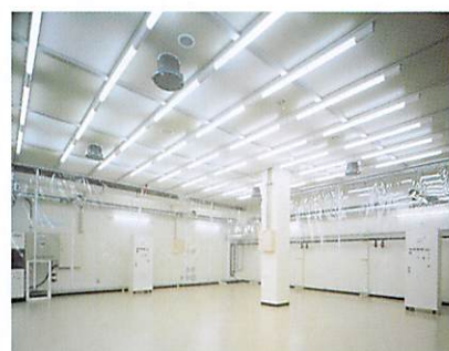
プラズマCVM室 (Class 1) Cr 2 O 3 不動態処理配管系を採用した世界最高性能の超高純度ガス供給系(加工用)を備えています。
