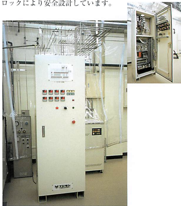
図2.20 ガス制御パネルの外観写真（プラズマCVM用10系統）
