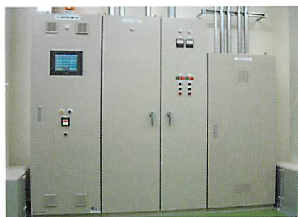
図2.22 ガス漏洩検知警報盤
