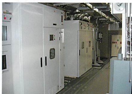
図2.18 排ガス処理装置
