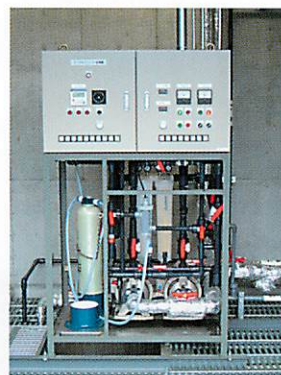
図1.12 ケミカルウォッシャー制御盤
