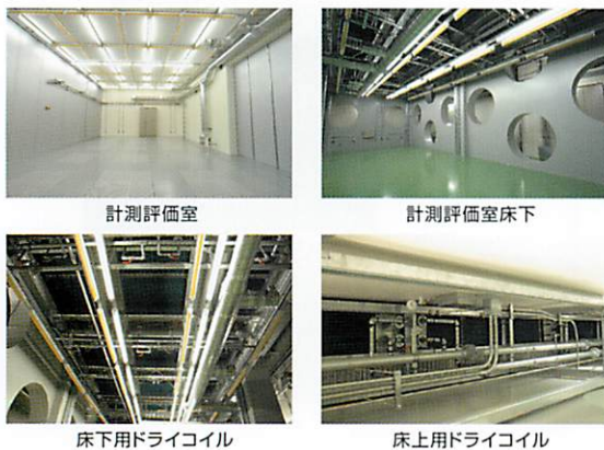
図1.15 空調システム2 (計測評価室)
