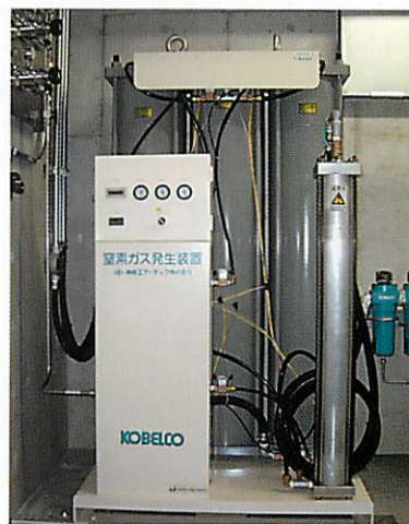
図2.20 PSA式窒素ガス発生装置
