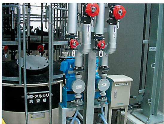
図3.20 酸・アルカリ移送設備
