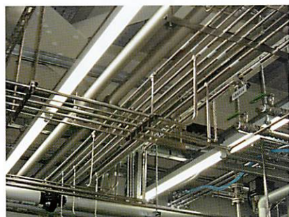
図2.13 超高純度ガス供給配管
