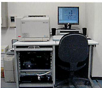
図4.1 中央監視システム（左：正、右：副）
