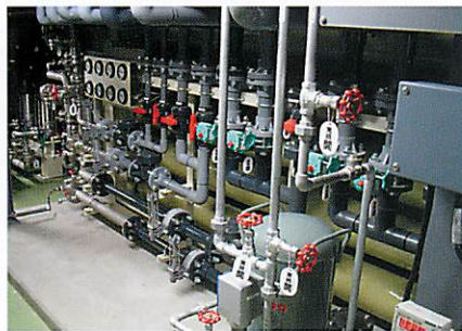
図3.5 超低压2段RO（逆浸透）装置
