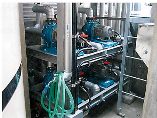
図3.19 廃液移送ポンプ設備
